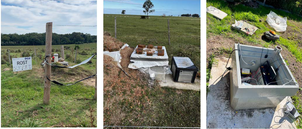
Figura 3. Instalaciones de la Red Sismológica Nacional, de izquierda a derecha: estación Parque Santa Teresa, Rocha (ROST); estación Río Branco, Cerro Largo (RBCL) y estación cerro de Montevideo, Comando de Infantería de Marina de la Armada (CIMM).
